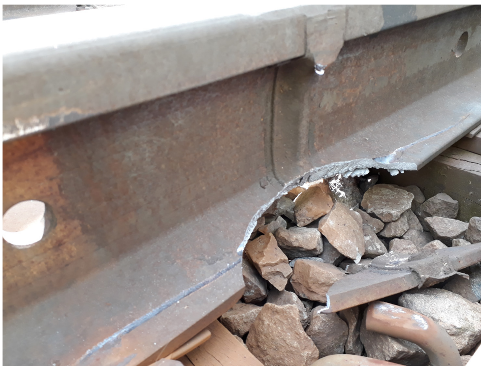
Afbeelding: de vastgestelde schade aan wissel 02C op 14 april 2020 (bron: Infrabel)
